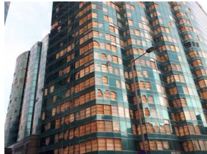
【台風による窓ガラスの破損】
